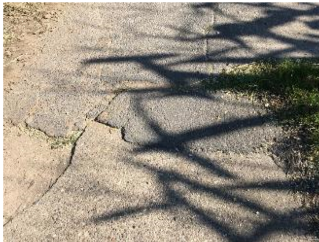
Abbildung 92: Schäden an der Wegedecke zwischen Rheurdt und Aldekerk (Quelle: eigenes Foto)
