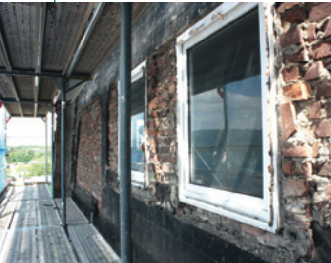
Neubau der Hochschule Rhein-Waal, Campus Kleve. Der alte Getreidespeicher erhält neue Fenster, 2010, Fotograf: Heinz Leenders (KA Kle F18, 69)
